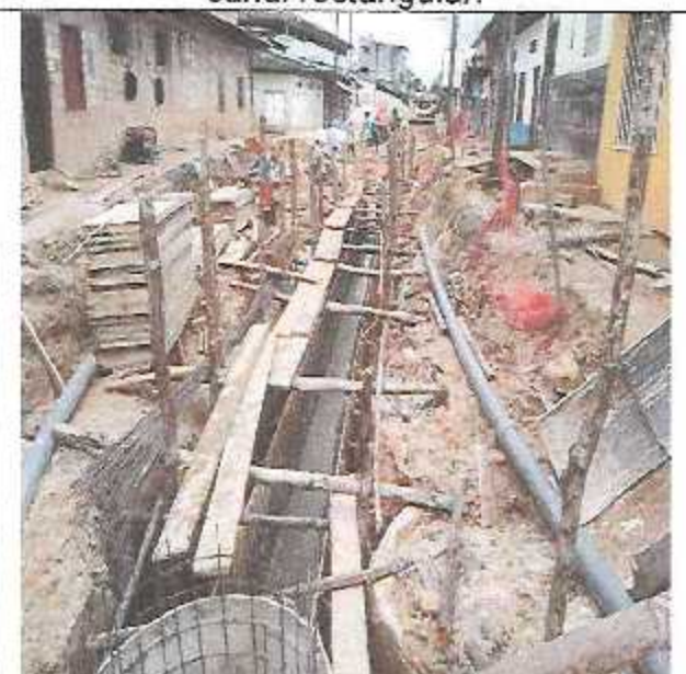
Llenado de mortero en muros de canal en calle prolongación José Gálvez.
